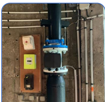
Réservoir de Genainville (refoulement distribution)
