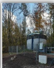
Réservoir de Hodent (capacité : 80 m³)
