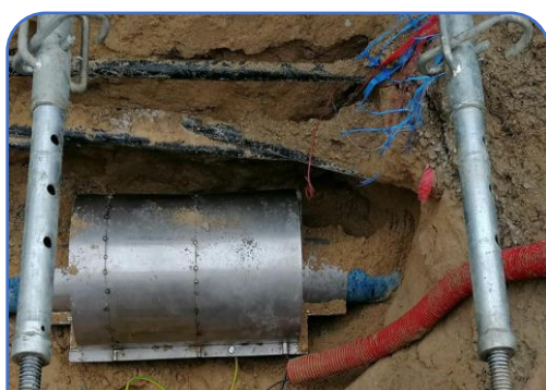
Rue Eugène Blouin (débitmètre enterré)
