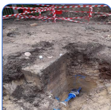
Réservoir de Hodent (refoulement)
