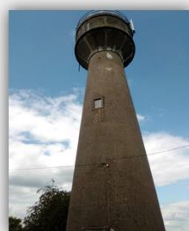
Réservoir de Genainville (capacité : 100 m³)
