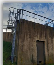
Réservoir de Chaussy (capacité : 600 m³)
