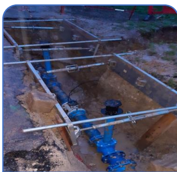
Rue des Tourelles (débitmètre enterré)
