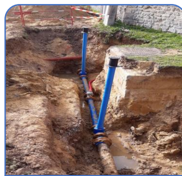
Rue du Moulin de la Planche (débitmètre enterré)
